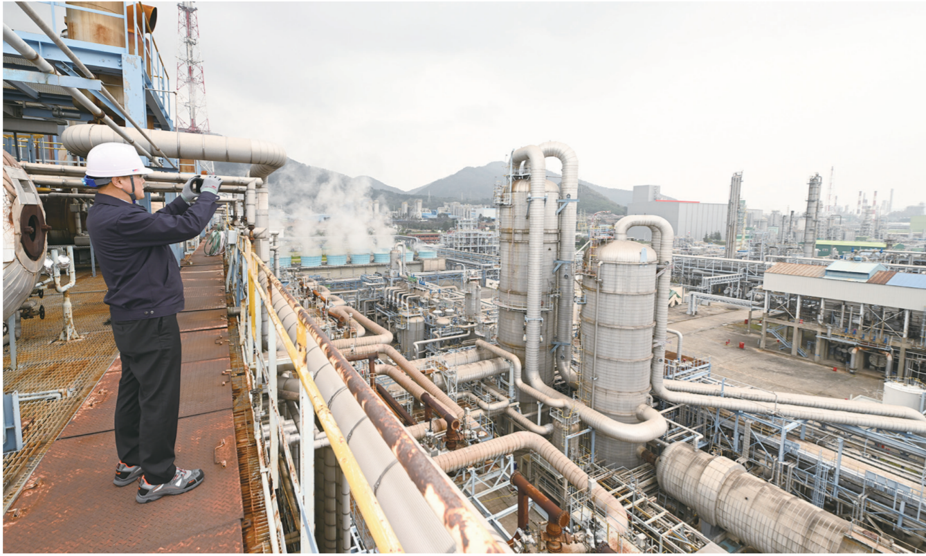
중동발 나프타대란이 이어지고 있는 가운데 전남 여수시 여수국가산단 내 여천NCC에서 나프타가공 설비들이 가동되고 있다. /뉴스시스
