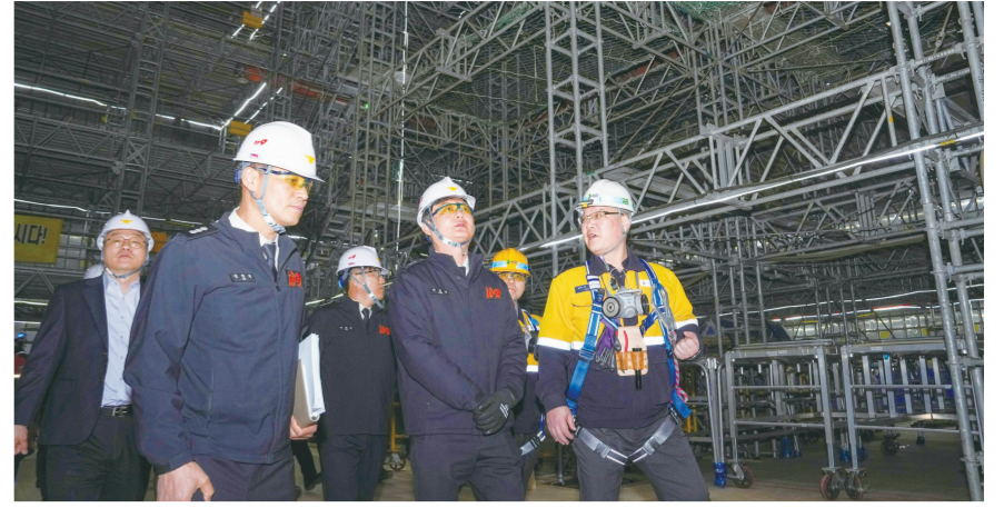
지난 16일 HD현대삼호김재를사장과 최민철 전남소방본부장이 회사 안벽에서 건조 중인 LNG운반선에 승선해 작업현장을 둘러보고 있다.
