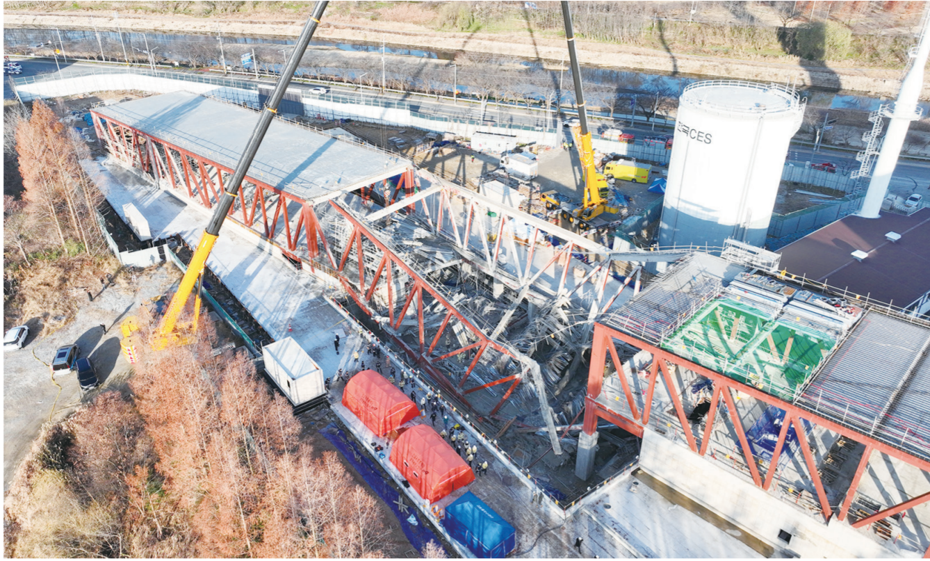
스방당국이 11일 오후 광주 서구 치평동 광주대표도서관 건설 도중 난 콘크리트 타설 작업 중 구조물 붕괴 사고 현장에서 간해물에 매몰된 것으로 추정되는 작업자들을 수색 구조하고 있다.
