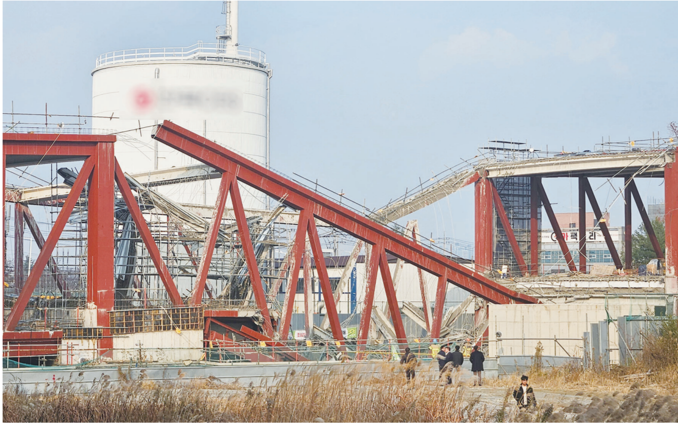
11일 오후 광주 서구 치평동 광주대표도서관 건설 현장에서 콘크리트 타설 작업 중 구조물 붕괴 사고가 나 소방 당국이 잔해물에 매몰된 것으로 추정되는 작업자 4명을 구조 중이다. /뉴스1
