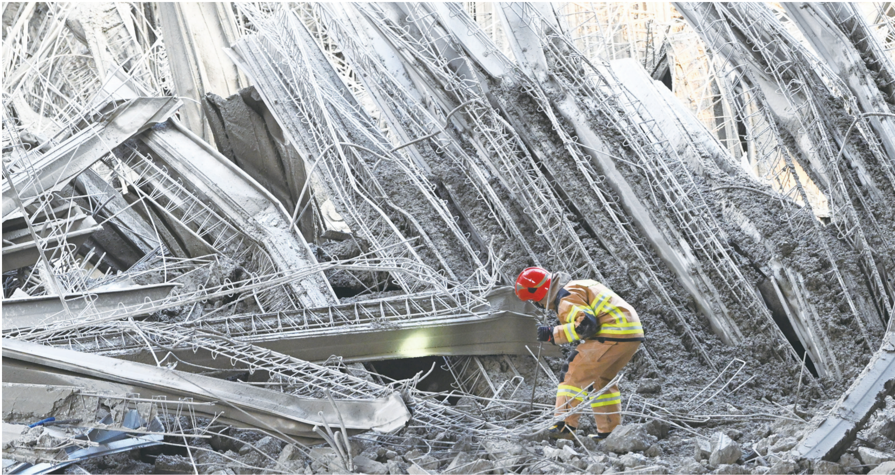
소방당국이 11일 오후 광주서구 차평동 광주대표도서관 건설 도중 난콘크리트 타설 작업 중 구조물 붕괴 사고 현장에서 전해물에 매몰된 것으로 추정되는 작업자들을 수색 구조하고 있다. /뉴시스
