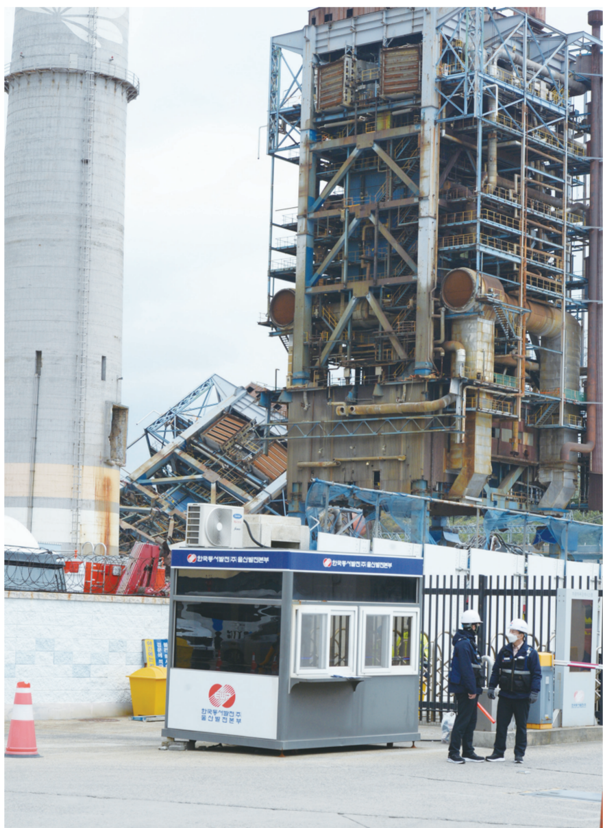
‘매몰자는 어디에?’ 울산 남구 용감동 한국동서발전 울산화력발전소 대형 구조물이 무너지는 사고 발생 사흘째인 8일 오전 소방관 등 관계자들이 매몰자 구조 작업을 하고 있다. /뉴시스
