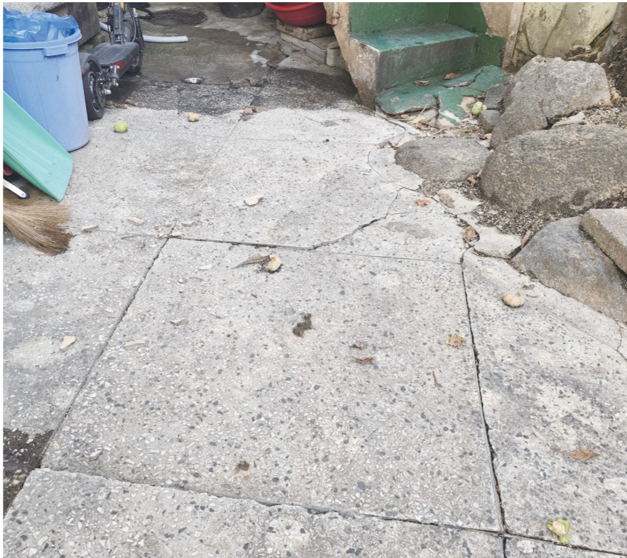
광주 도시철도 2호선 6공구 공사로 발생했다는 노후 주택 균열 현장
