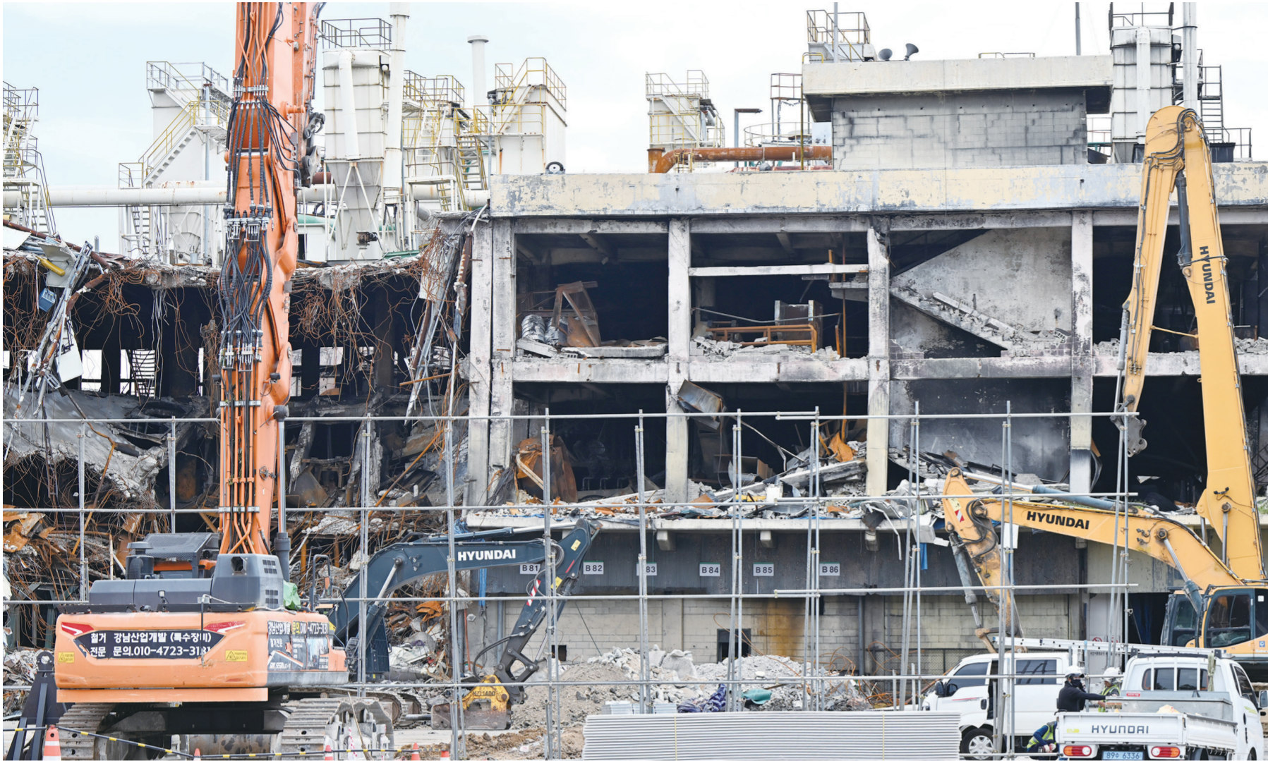
지난 8일 오후 대형 화재가 발생한 광주광역시 금호타이어 광주공장 2공장 정련동 건물 해체 작업을 위해 기막 설치가 이뤄지고 있다. 지난 5월 17일 불이 난 정련동 건축물은 오는 11일부터 본격적인 해체에 돌입, 11월 10일까지 작업을 마칠 예정이다. /뉴스시스
