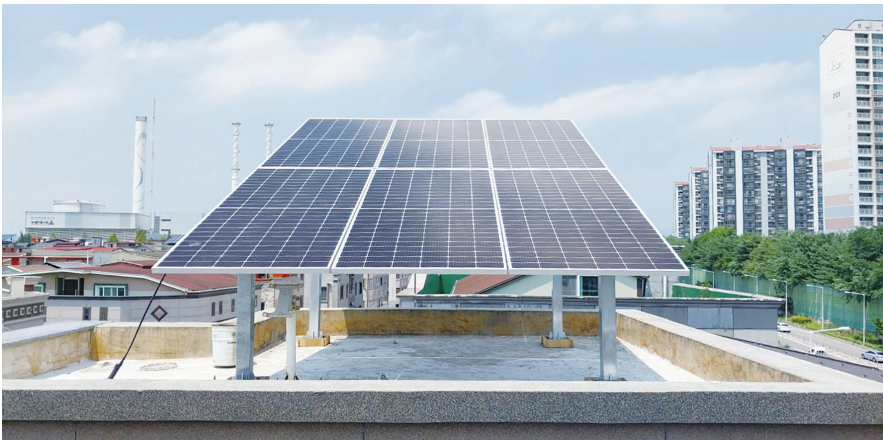
주택 옥상에 설치된 태양광 시설.
